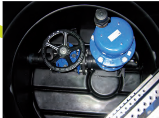
Be- und Entlüftungsschacht
