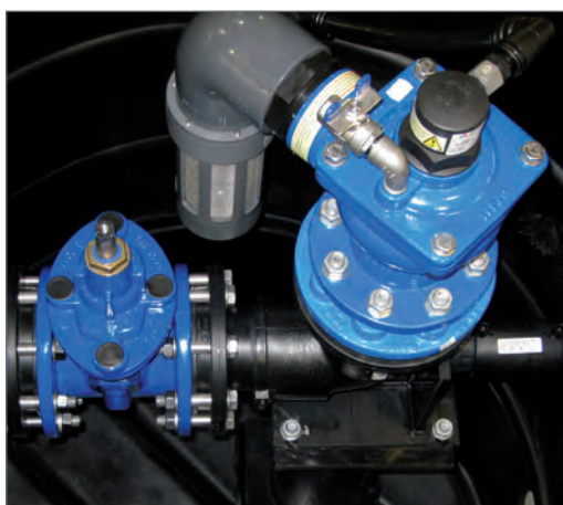
Be- und Entlüftungsschacht mit Rückstausicherung
