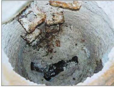
Ausgangssituation: korrodierter Betonschacht
