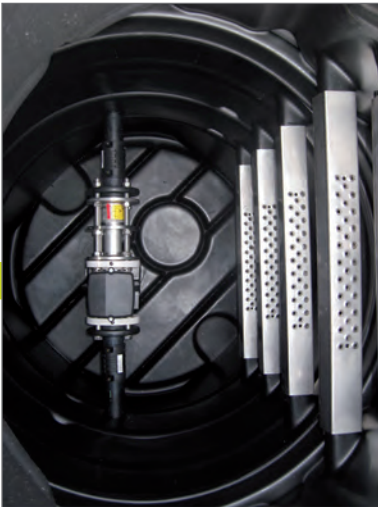
Wasserzählerschacht mit MID-Messgeräten
