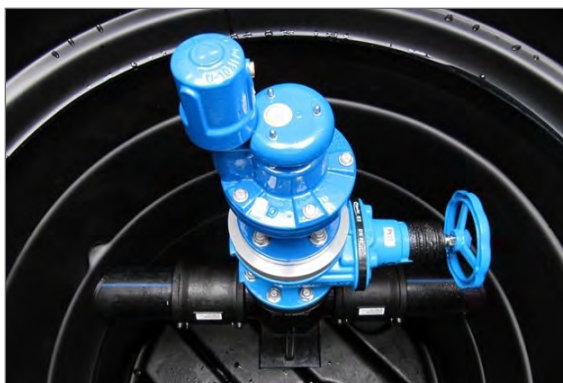
Be- und Entlüftungsschacht mit durchgehender Leitung
