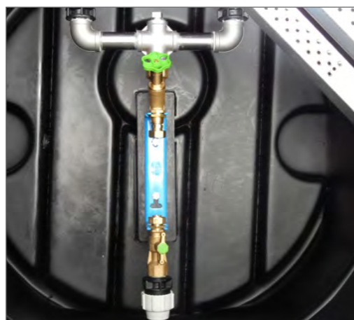
Wasserzähler mit nachfolgender Verteilung
