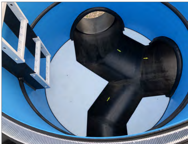
Schacht DN 1500, Gerinne Da 710, seitlicher Zulauf Da 500
