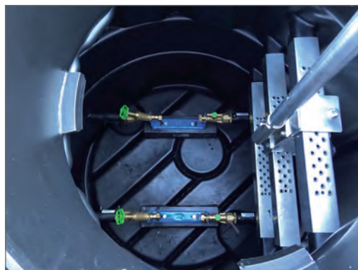
Wasserzählerschacht mit integrierten Einbaugarnituren
