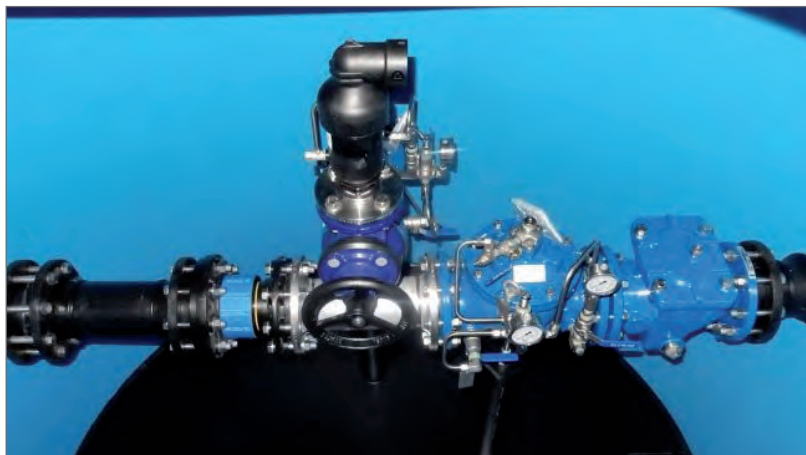
Druckreduzierventil und Entlüftung
