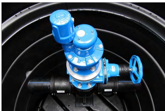
Be- und Entlüftungsschacht mit durchgehender Leitung
