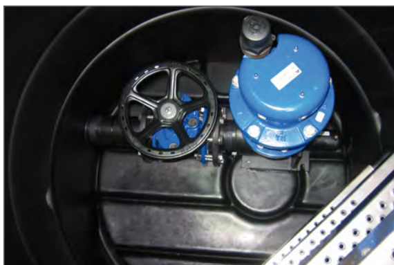
Be- und Entlüftungsschacht als Seitenanschluss
