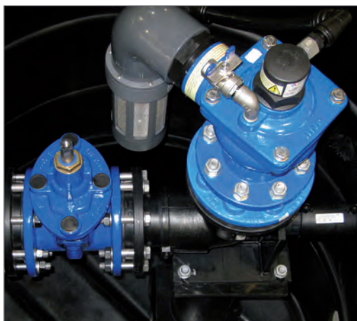
Be- und Entlüftungsschacht mit Rückstausicherung
