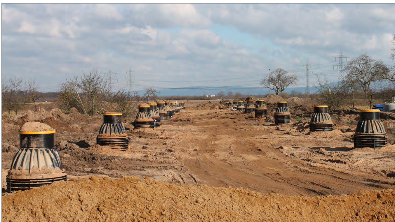
Siedlungerschließung mit Schacht PP DN 1000
